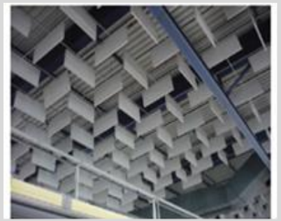
Plafond de local industriel avec baffles
